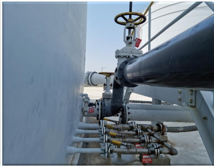
설치된 임시 배관
