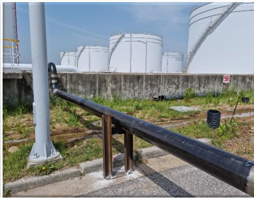
설치된 임시 배관
